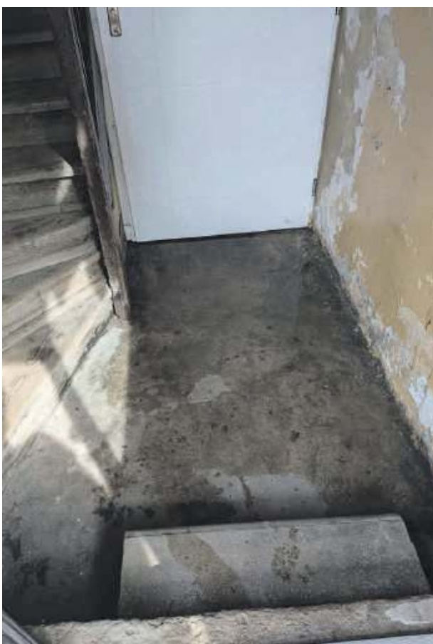
Woda na klatce schodowej
