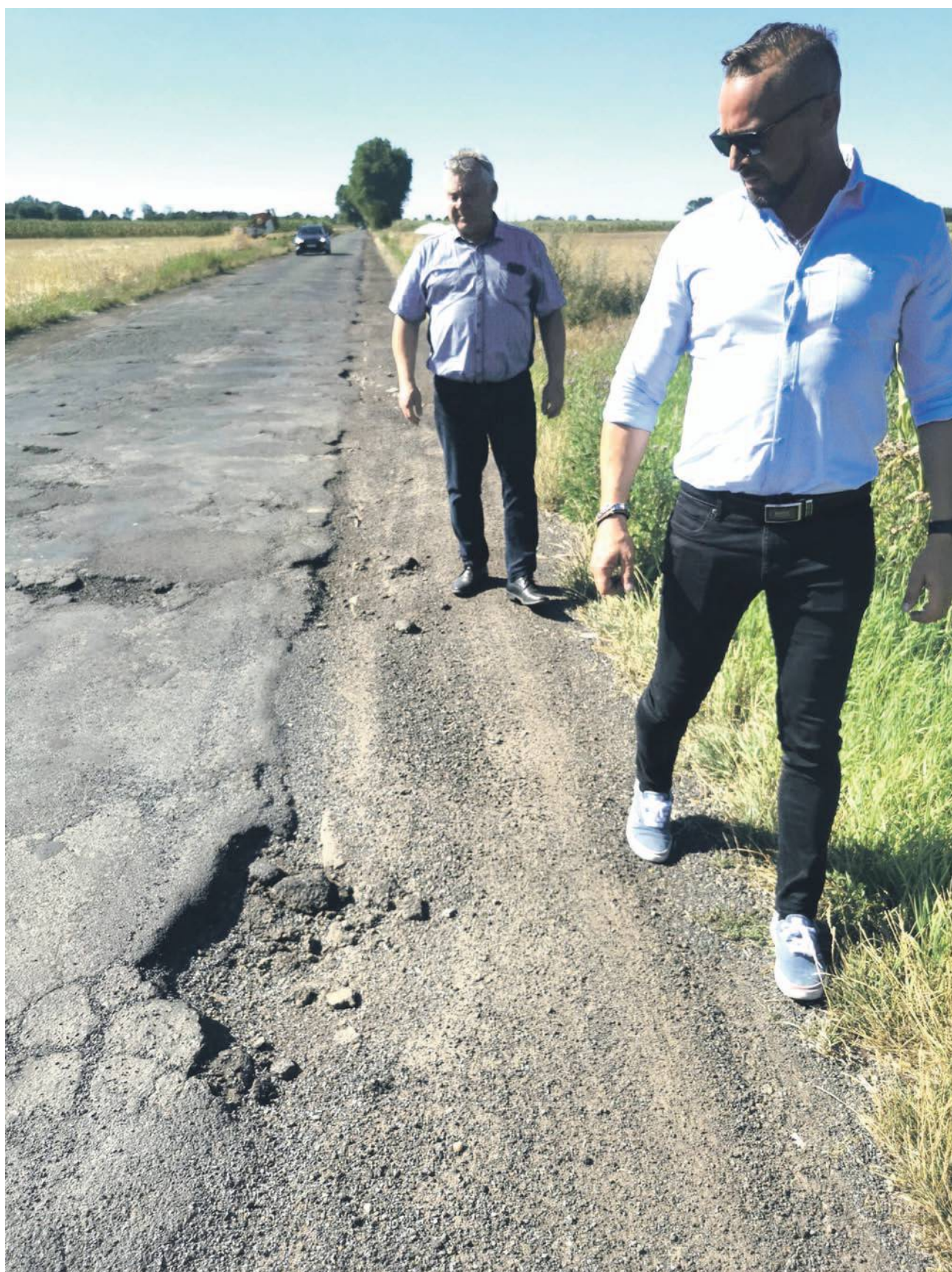
Droga do Milonowa dosłownie rozpadała się. Mieszkańcy tracili nerwy i zawieszenie aut. Radni Szymon Kościelak i Mariusz Olender walczyli o remont. Zdjęcie zrobione pod koniec lipca
