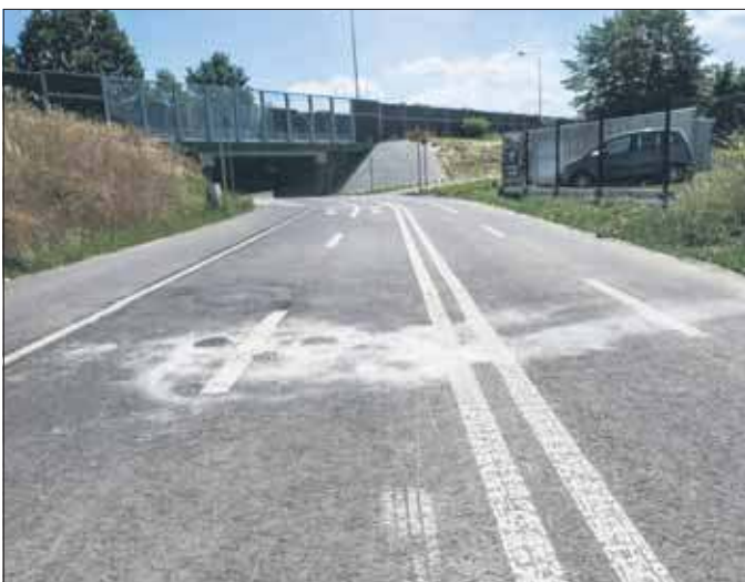
Uszkodzony asfalt jest prawdopodobnie efektem wysokich temperatur
