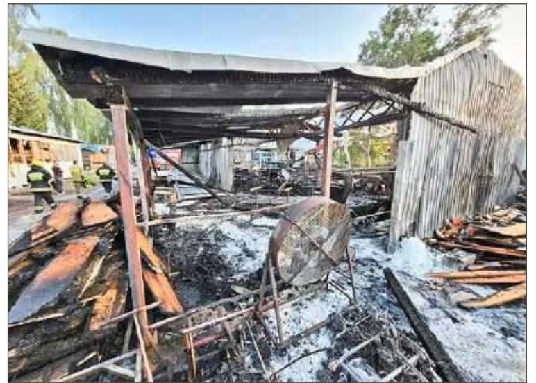
Ogień strawił cały budynek wraz z wyposażeniem. Fot. OSP Pilzno.
