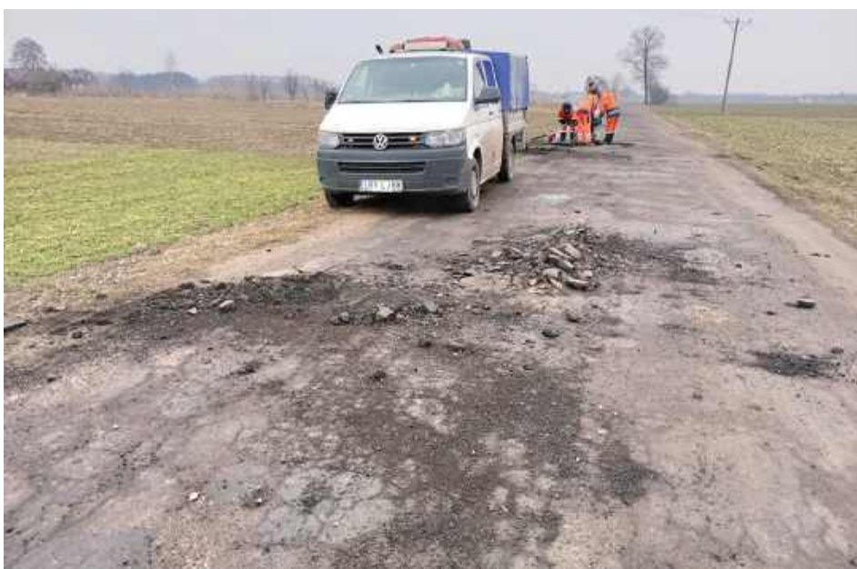
Zdjęcie przedstawia fragment drogi powiatowej w miejscowości Sędowice. Podczas sesji Rady Gminy Ryki radny z tego terenu zwrócił się z prośbą do władz gminy o interwencję w starostwie powiatowym w sprawie przeprowadzenia modernizacji drogi. Jak informował nas starosta, nie na wszystkie odcinki dróg są pieniądze, ale bieżące remonty są wykonywane cały czas
