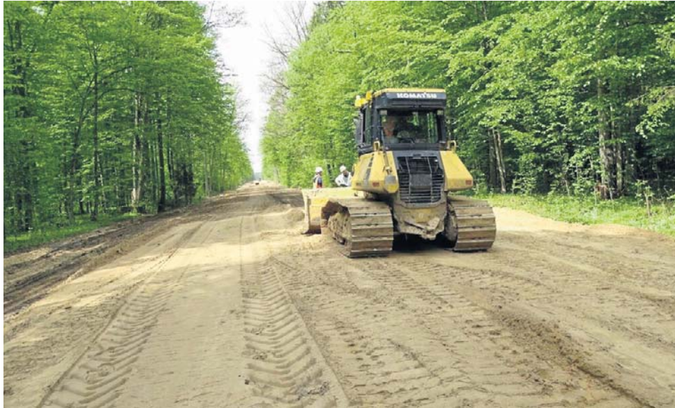
Spór dotyczy przebudowy drogi wojewódzkiej Zwodzieckie - Juskowy Gród. Ekolodzy sprzeciwiają się modernizacji szlaku przez Puszcze Białowieską
