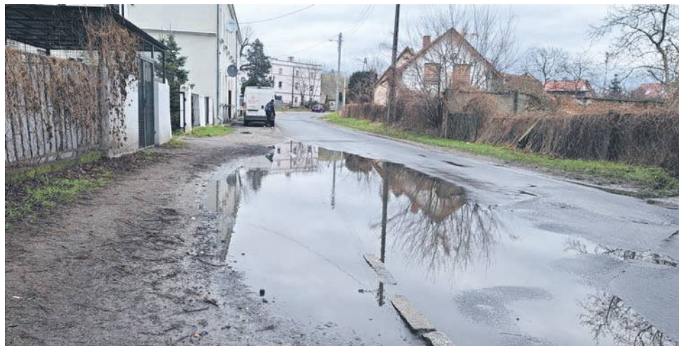
Z drugiej strony ulicy pobocze jest wyżej niż ulica, więc woda stoi, bo studzienki są pozapychane
