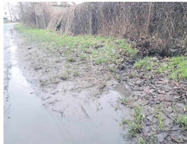
Z jednej strony drogi ktoś wykopał odpływ, więc woda z drogi trochę szybciej spływa. Tak sobie tymczasowo radzą mieszkańcy
