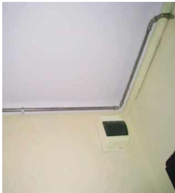
Rurka ciepłej wody w mieszkaniu
