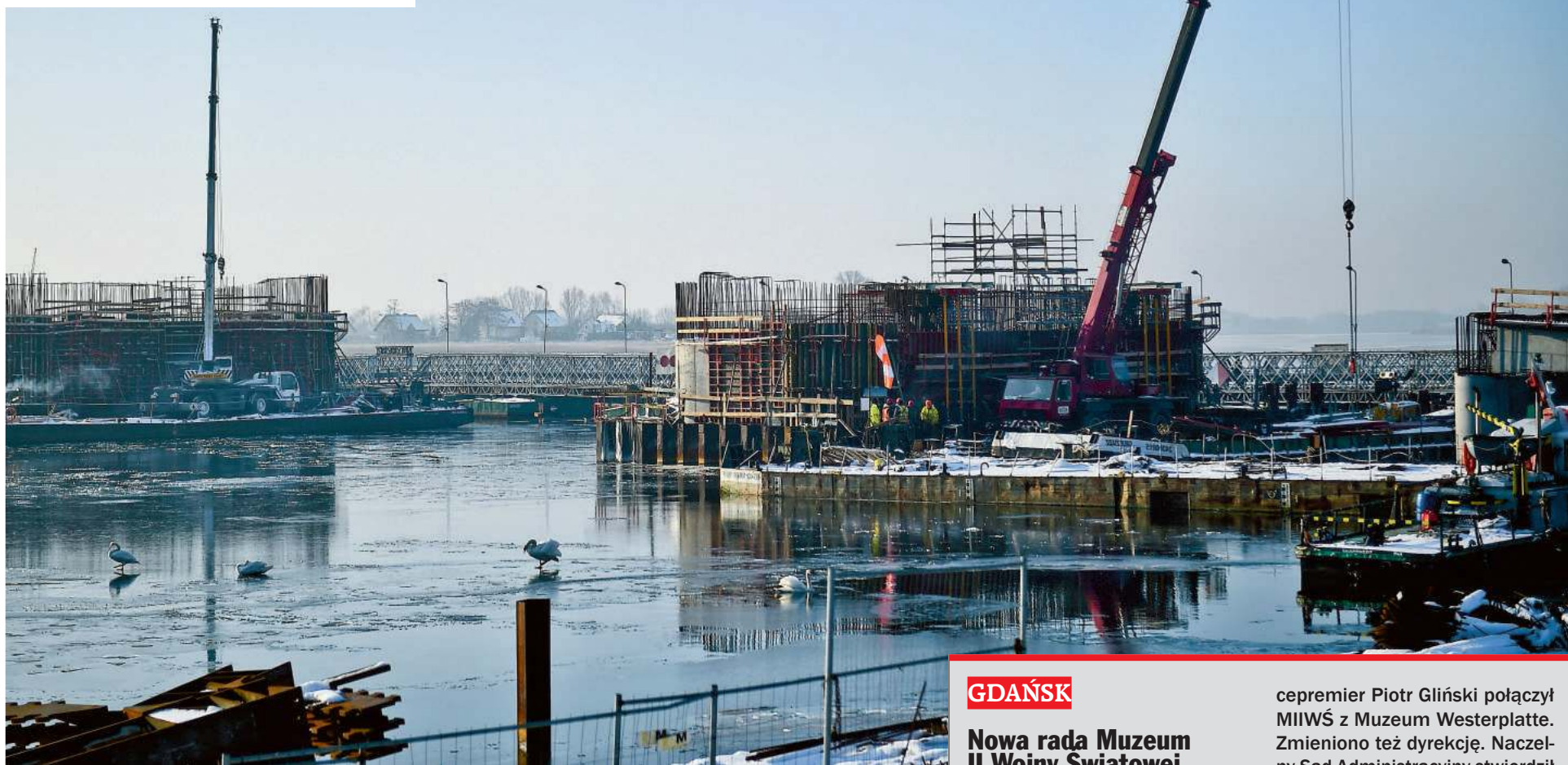
Zatrzymana budowa mostu na Wyspę Sobieszewską | fot. Fotomag/Gazeta Polska
