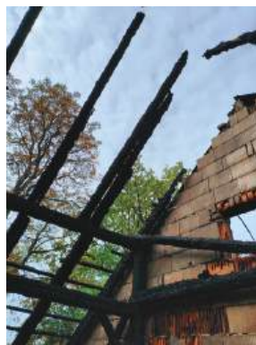
Pozostałości konstrukcji dachu po pożarze. Fot. archiwum prywatne
