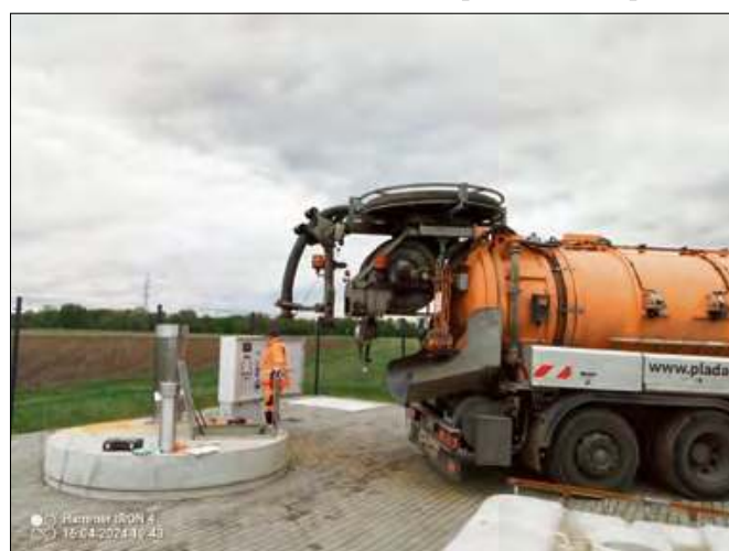
Dzięki tak kompleksowemu podejściu do serwisu przepompowni ścieków, Plada zapewnia ich długotrwałe i bezproblemowe działanie.
