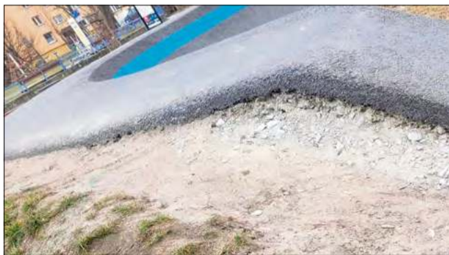
Pumptrack w Niemodlinie został tymczasowo zamknięty – trwają prace naprawcze po intensywnym użytkowaniu obiektu.
