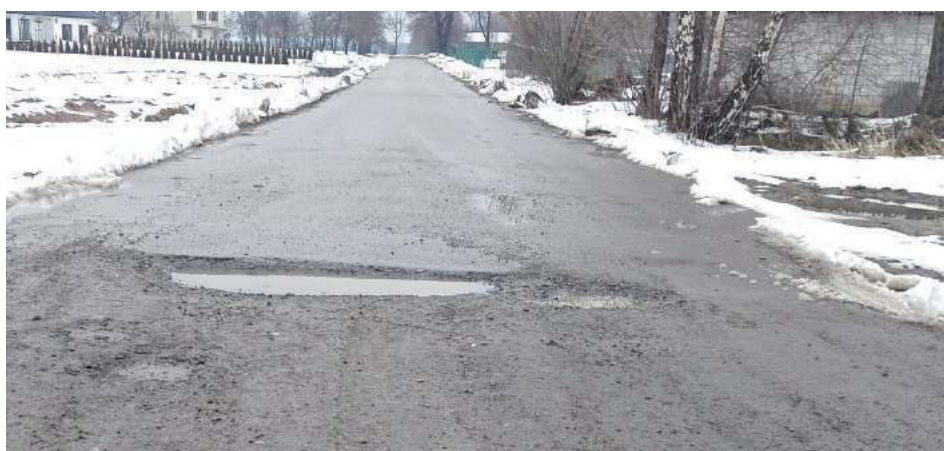
- Obecnie mamy dwie nowe drogi asfaltowe, a pomiędzy nimi ... 10 metrów z dziurami, które mogą uszkodzić samochód - pisze mieszkanka Różańca
