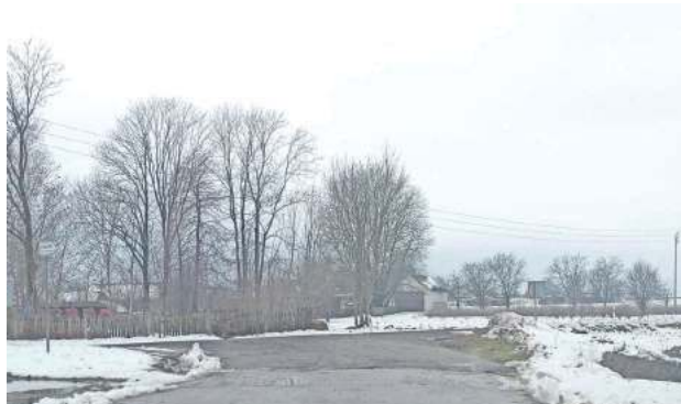
- Obecnie mamy dwie nowe drogi asfaltowe, a pomiędzy nimi ... 10 metrów z dziurami, które mogą uszkodzić samochód - pisze mieszkanka Różańca
