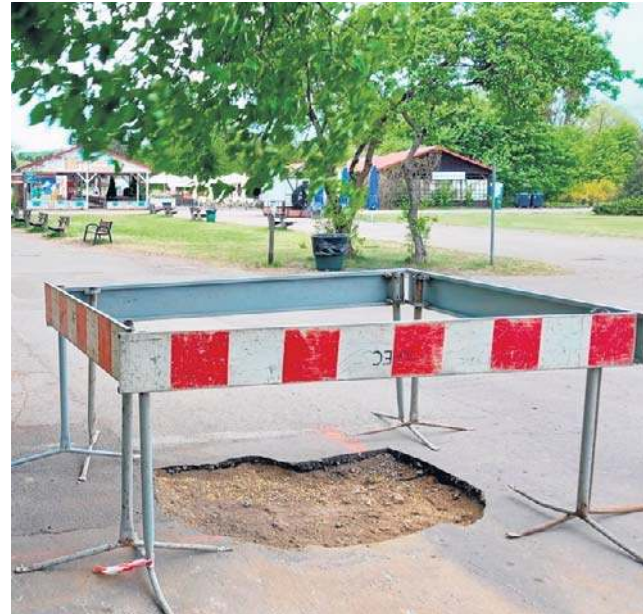
Wyrwy na głównym wjeździe na teren „Myślęcinka” będą załatwane
