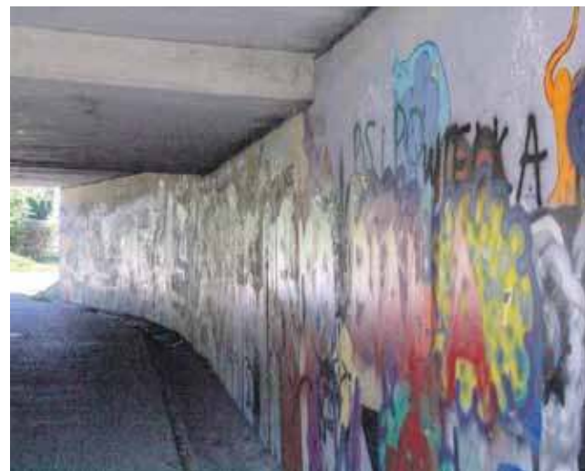
Przeście pod zakopianką - jedno z ulubionych miejsc wandalów ze sprayem w rękę. Po zamontowaniu kamery - bohomazów jest mniej. Trzeba jeszcze tylko stare usunąć.
