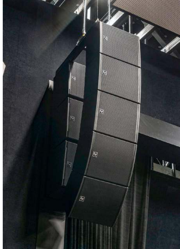
Za odpowiednie nagłośnienie sali widowiskowej odpowiada system EV EVA2082S, zawieszony w dwóch gronach po 5 sztuk, uzupełniony subbasami EVA1151D, zawieszonymi za zestawami pełnopasmowymi.
