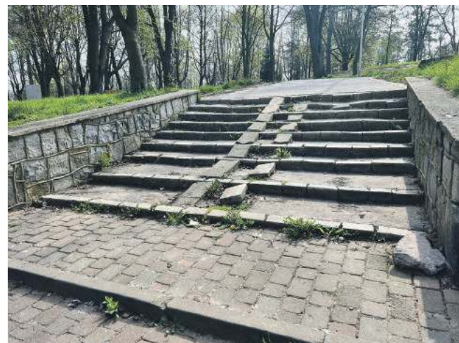
W drugim etapie mają być, między innymi, remontowane schody, które w tej chwili wyglądają fatalnie
