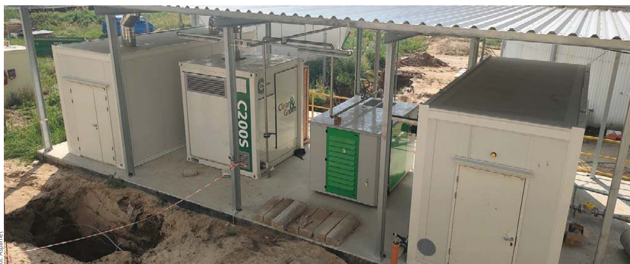
Mikroturbina biogazowa — instalacja
