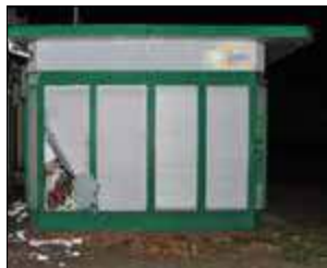
39-latek wyłamał fragment jednej ze ścian budynku
