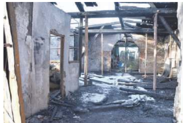
Magazyn ze spalonym dachem
