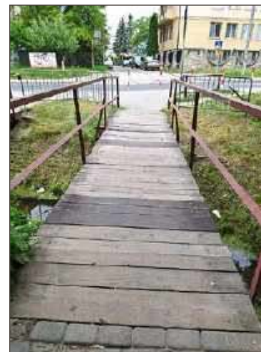
Z kładki ktoś powyrywał deski.
