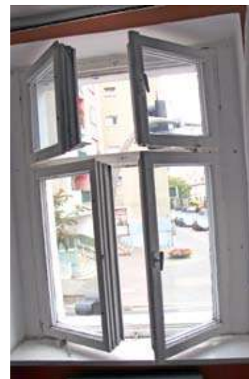
Okna wymagają naprawy
