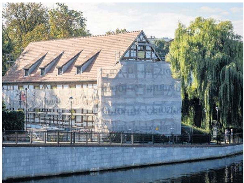
Biały Spichrz jest w dobrym stanie technicznym, ale wymaga regularnych prac konserwatorskich. Trwa kolejny remont obiektu
