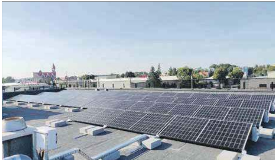
Firma montuje instalacje elektryczne i fotowoltaiczne dla domu, rolnictwa i przemysłu
