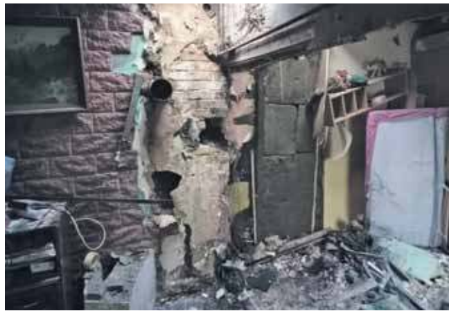
Spalone mieszkanie wymaga gruntownego remontu
