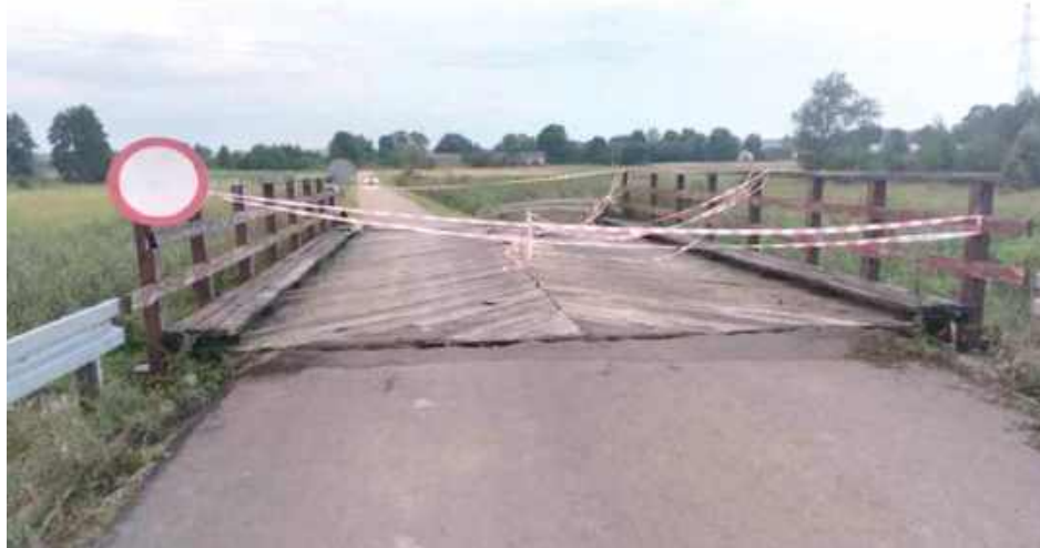
Degradacji mostu dopełniły ciężkie samochody, które nie stosują się do oznakowania i tonażu
