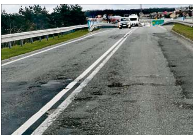
Uwaga kierowcy: na szczycie wiaduktu - dziura na dziurze.
