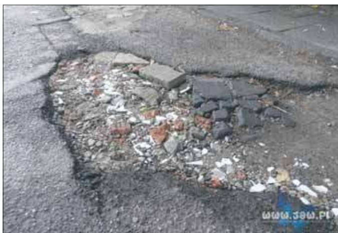
Dziura wypełniona potłuczonymi kafelkami i gruzem
