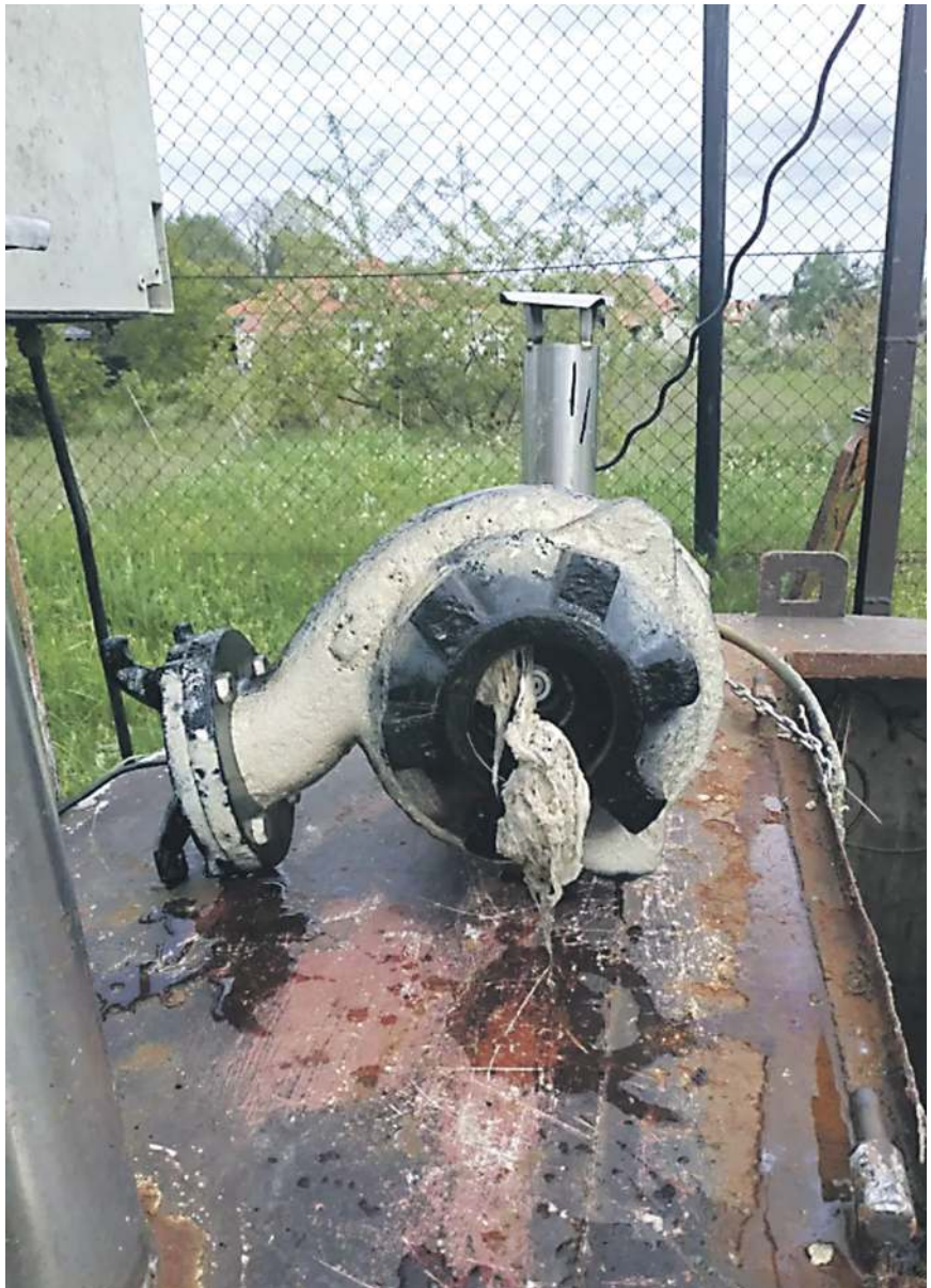
Na zdjęciu urządzenie kanalizacyjne zapchane mokrymi chusteczkami nawilżającymi
