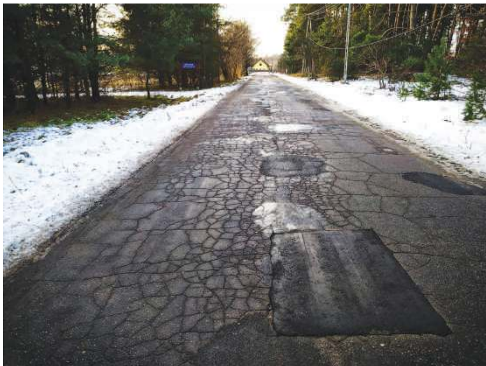
Odcinek w Nowinach (gm. Leoncin) już od wielu lat czeka na remont
