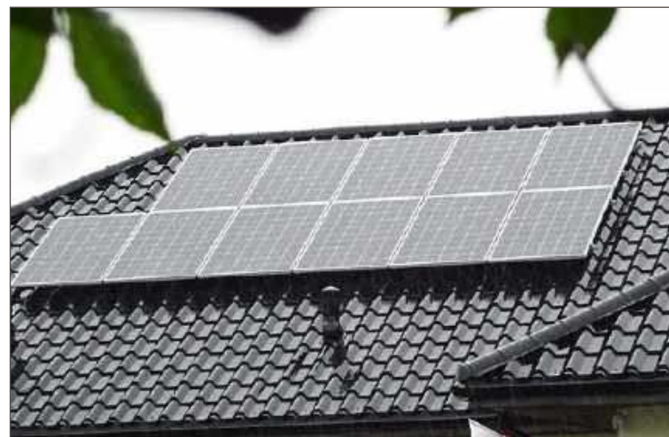
Jedną z opcji będzie instalacja fotowoltaiczna.
