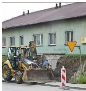
Po odsłonięciu fundamentów okazało się, że są one w fatalnym stanie.
