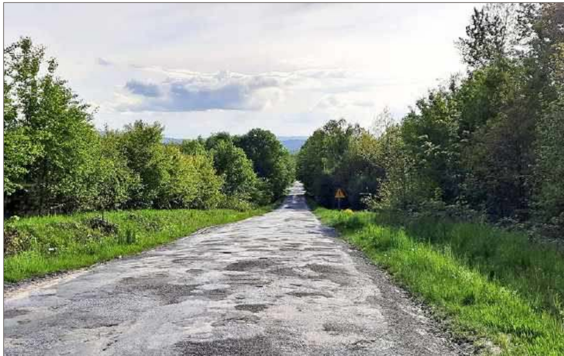
Droga, której remont najprawdopodobniej ruszy w ciągu miesiąca jest bardzo zniszczona.
