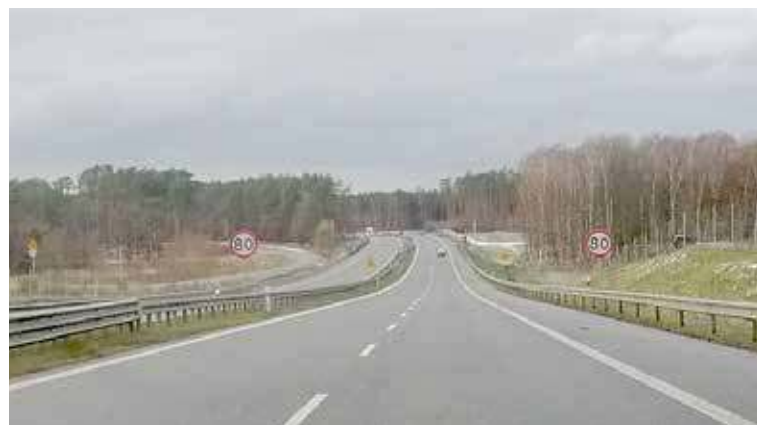
W tym miejscu już jakiś czas temu ustawiono znaki ostrzegające o nierównościach w jezdni i te ograniczające prędkość do 80 km na godz.
