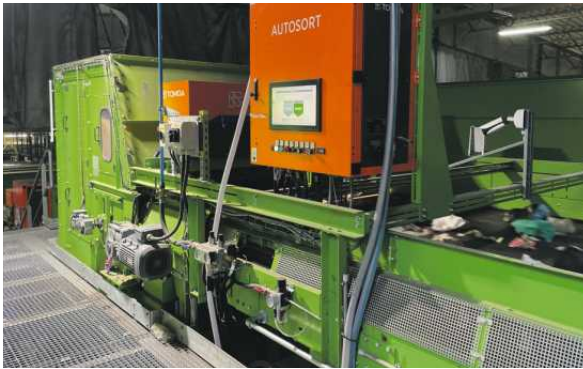
Sortownia odpadów komunalnych w ZUT Gdańsk
