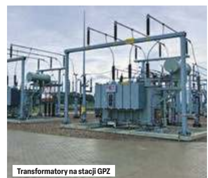
Transformatory na stacji GPZ
