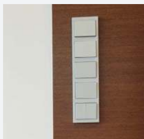
➤ W strefie dziennej łączniki oświetleniowe pogrupowane w pionowych ramach.
