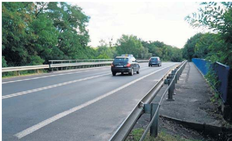
Pogarsza się stan wiaduktu na Koszalińskiej w Poznaniu
