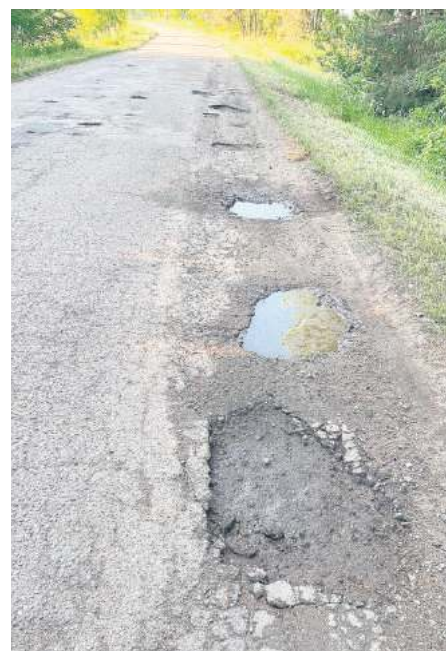
Droga w gminie Grębków fot. arch.
