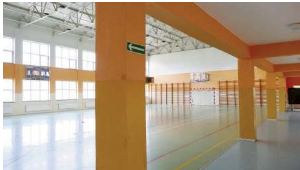
Po zderzeniu z tymi kolumnami skutki mogą być tragiczne. Dlatego remont będzie polegał m.in. na obudowaniu ich materiałem amortyzującym
