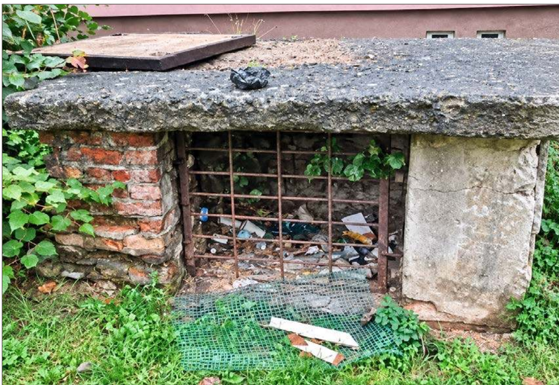
Tak wygląda otwór wentylacyjny jednego z miejsc schronienia na osiedlu Krakowska-Południe.
