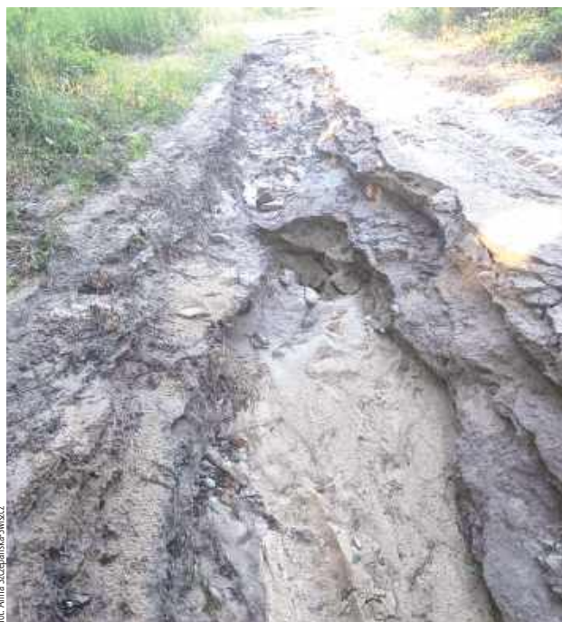
Takie wyrwy w drodze ul. Piasecznica zrobiła ulewa, jaka przeszła nad Puławami na początku lipca
