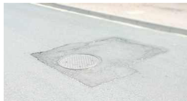
Asfaltowe łaty pękają i nawierzchnia jest nierówna
