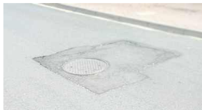
Asfaltowe łaty pękają i nawierzchnia jest nierówna
