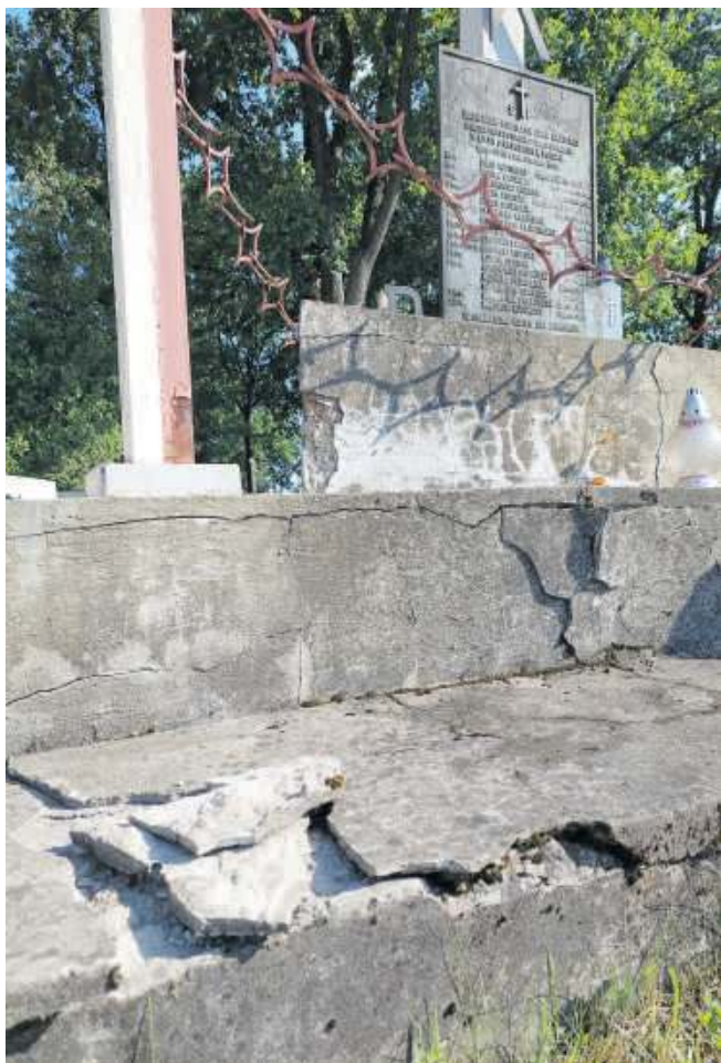
Płyty cokołu są już bardzo zniszczone
