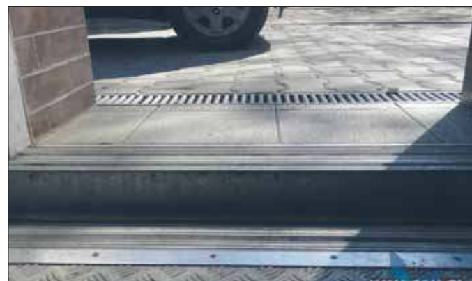
Winda, która utknęła około 10cm poniżej poziomu podłoża
