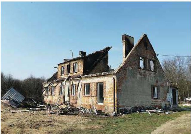
Budynek nie nadaje się do zamieszkania
