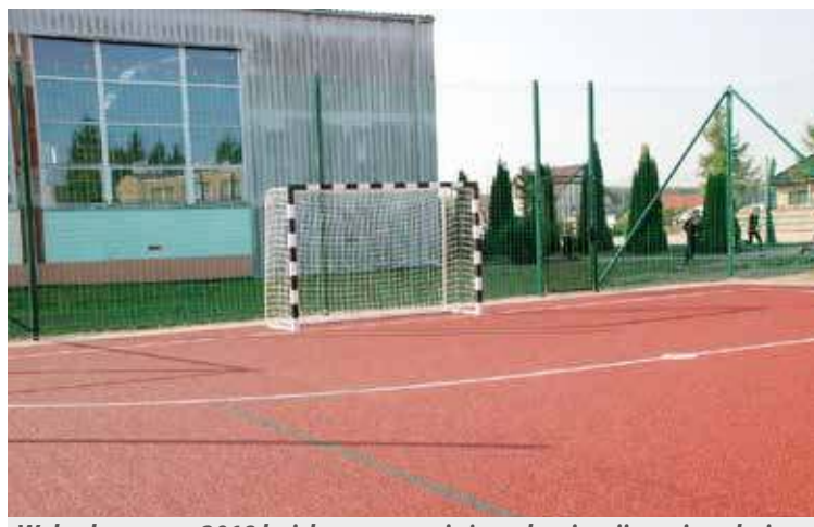
Wybudowane w 2018 boisko wymaga już modernizacji nawierzchni
