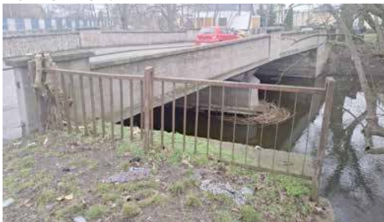
Ta barierka, jak wskazuje radny, wymaga naprawy. Jest skorodowana
