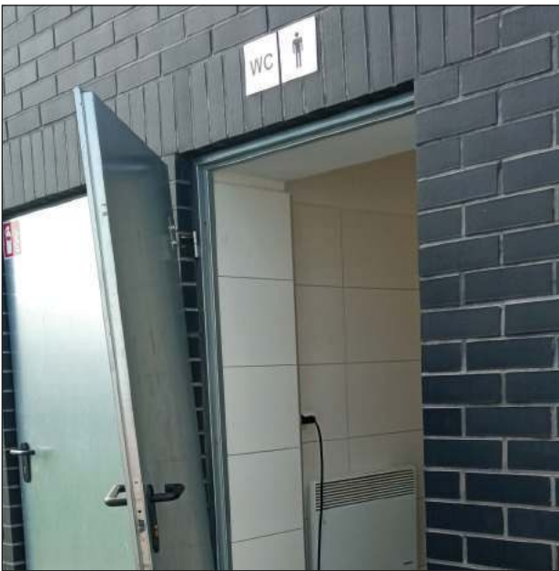
Przekrzywione, utrzymujące się na jednym zawiasie drzwi do toalety przez wiele miesięcy odstraszały męż- czyzn chcących skorzystania z toalety
