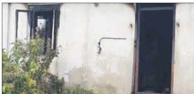
Budynek uległ częściowemu spaleniu
