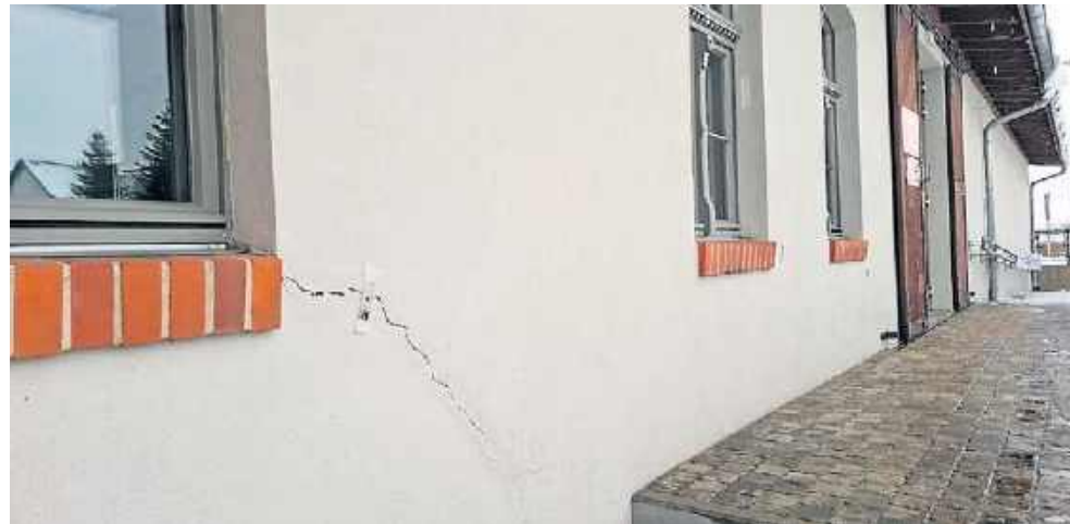
Wykonawca przygotował plan naprawczy dla budynku przy kościerskim dworcu
