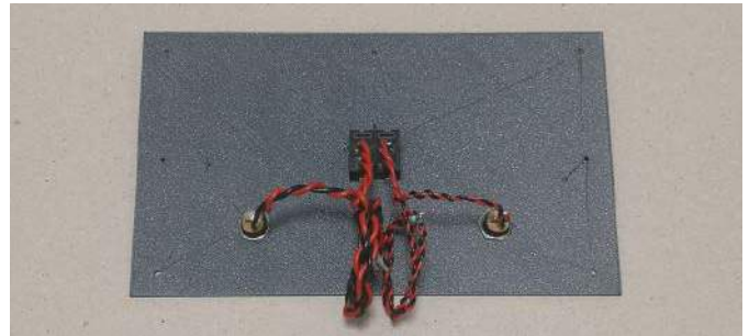
Fotografia 6. Połączenia pomiędzy złączami zasilania i włącznikiem głównym
